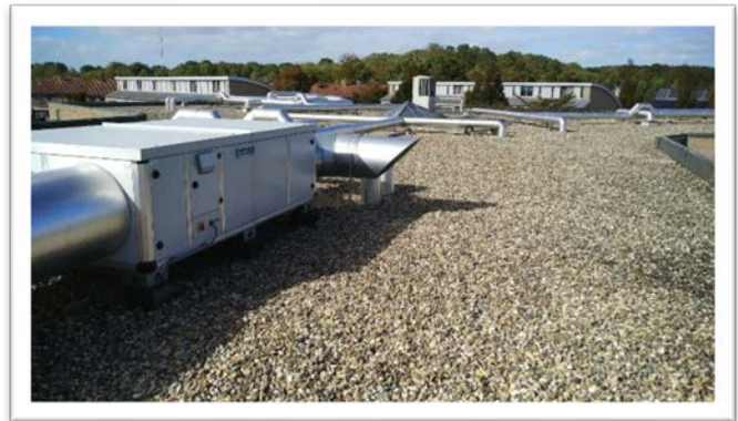
Warmte-terugwinningsinstallatie op dak Lelypark
